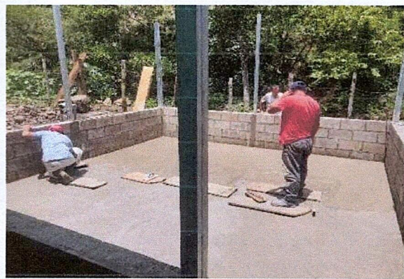
Foto 2: finalización de colocación de losa de piso torta del mejoramiento tipo pórtico.
