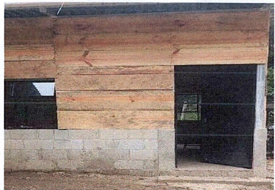
Foto 4: culminación de la instalación de puertas y Ventanas de mejoramiento tipo pórtico.
